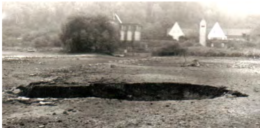
Abb. 16: Erdfall im wasserlosen Stausee, im Hintergrund Gebäude des ehem. Vorwerks
