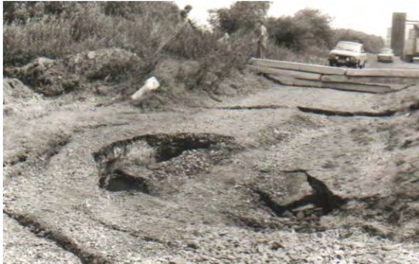
Abb. 15: Erdfall am Südrand des Stausees Kelbra
