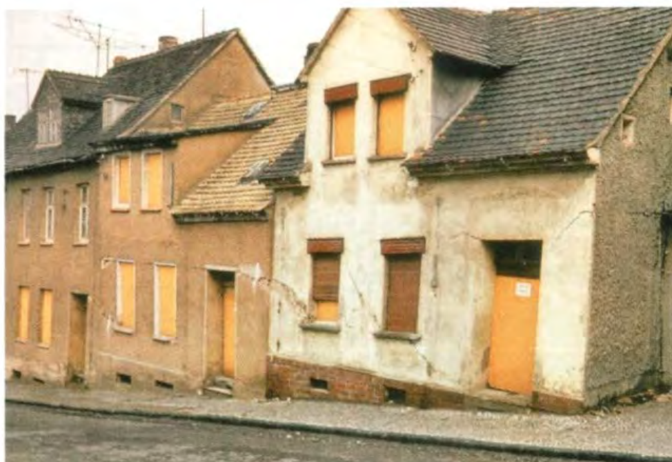
Abb. 22: Senkungsschäden in Eisleben (Siebenhitze)
