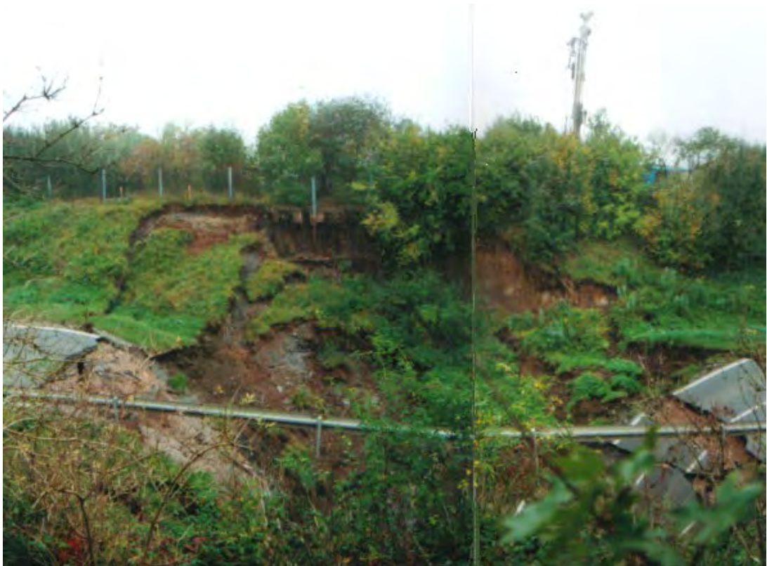
Abb. 20: Der Erdfall an der B 180 bei Neckendorf südlich von Eisleben 2001
