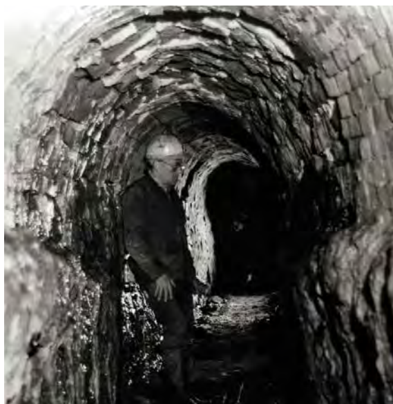
Abb. 6: Subrosionsbeginn von der Grenze Zechsteinkalk (unten)/Werraanhydrit (oben). Die Mauerung steht auf der OK Zechsteinkalk
