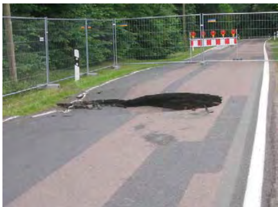
Abb. 1: Tagesbruch bei Morungen 2008 (Probst-Schacht)
