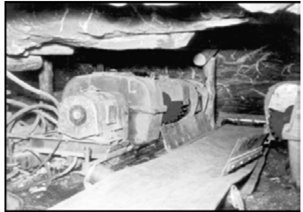
Abbildung 85: Antriebsstation einer Plattenförderbandanlage
