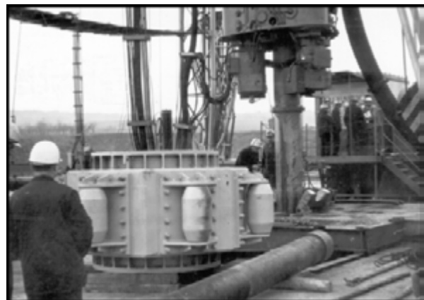
Abbildung 43: Schachtbohrgerät (Stabilisator für Bohrstrang) Schachtbau Nordhausen
