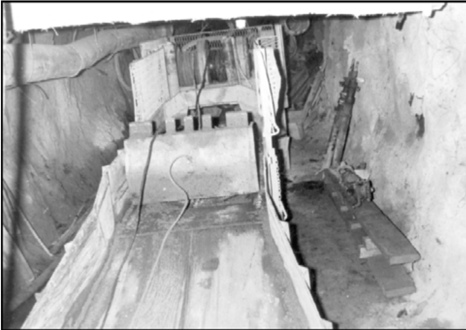
Abbildung 57: Auffahrschurre, Schrapkasten und Haspel einer Schrapanlage im Streckenvortrieb
