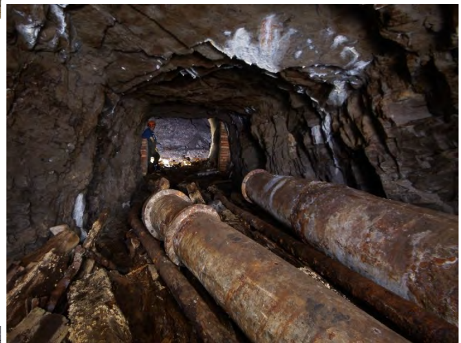
Verzinkte Lutten aus Stahlblech im „Magazin“, Segengottes-Stollen, Röhrigschacht Wettelrode. Ca. 1875
